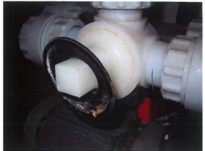
Abb. 7: Ablagerungen in einem Dreiweghahnen
