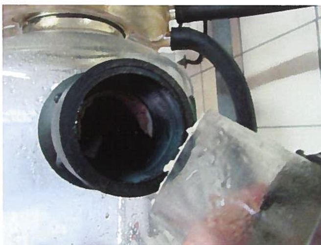
Abb. 6: Ablagerungen in Gummi-Dichtung der Endeinheit
