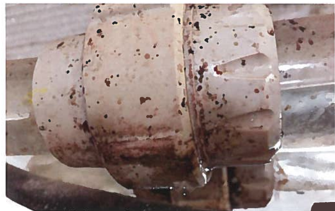
Abb. 13: Tropfende Milchleitung mit defekter Dichtung
