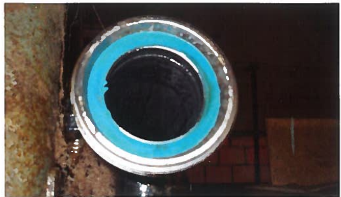
Abb. 11: Verschmutzte Verschraubung Schwenkbrücke
