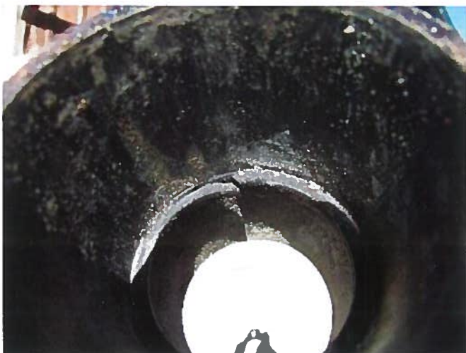
Abb. 10: Defekte Dichtung aus Milchleitung mit Ablagerungen
